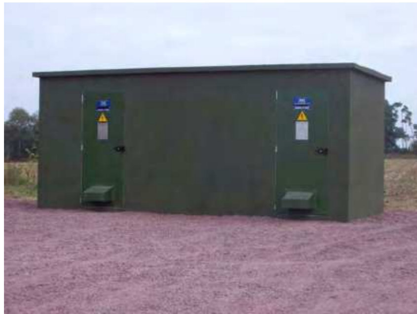
Photographie 125 : Exemple d'un poste de livraison (source : VSB)
